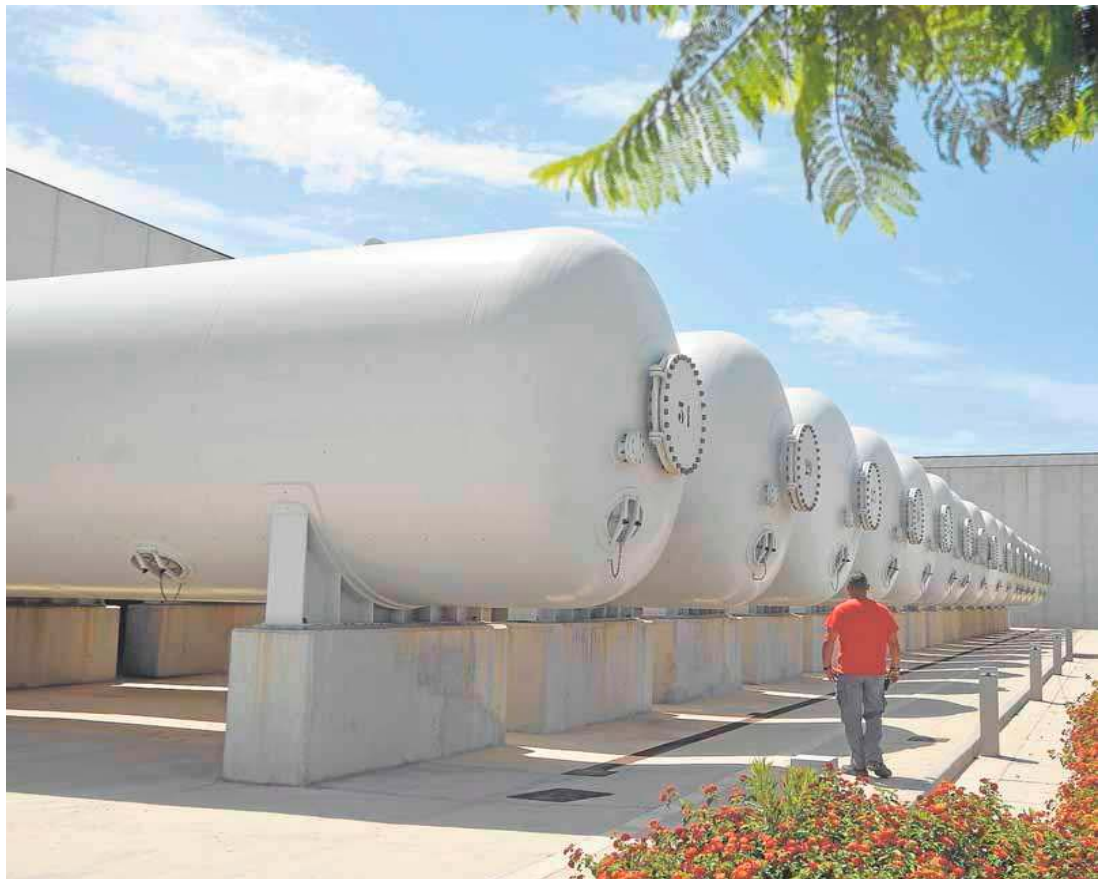
Instalaciones de la desalinizadora de Torrevieja. NACHO GARCÍA
